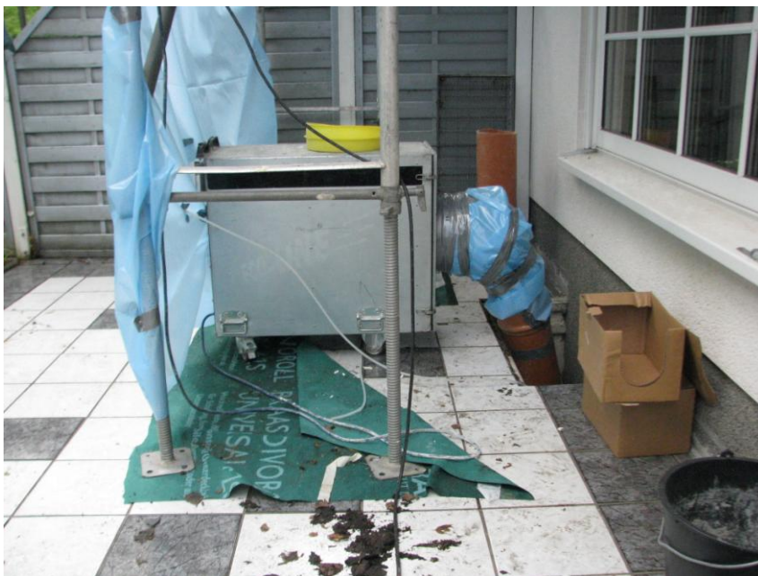
Bild 11 Absaugung mit kontinuierlicher Unterdruckhaltung über den Lichtschacht der Gartenfront..
