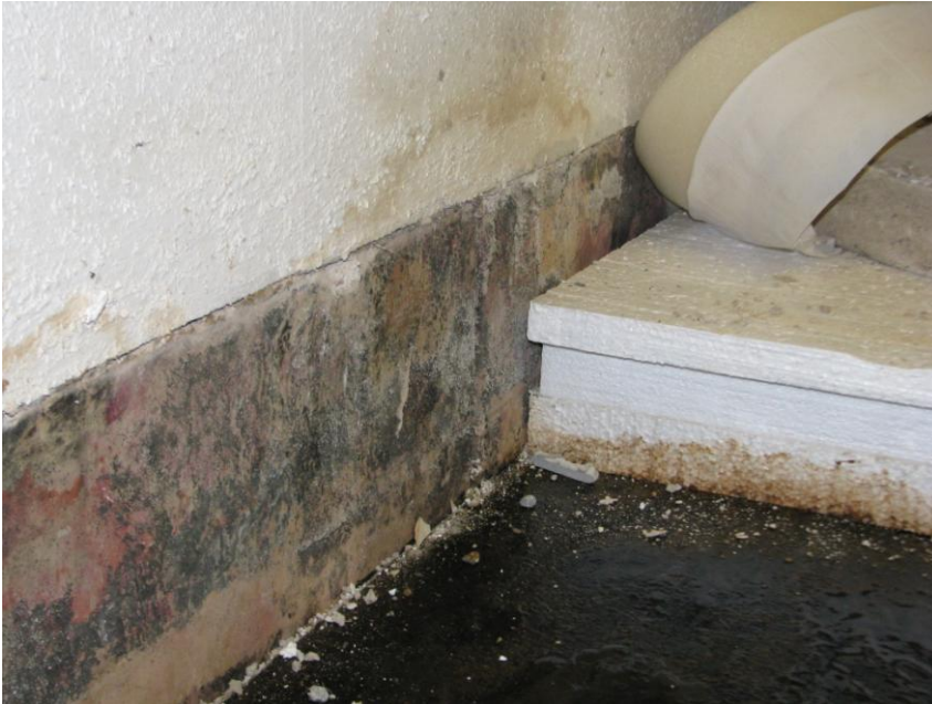
Bild 13 Durchgehender schwärzlicher Schimmelpilzrasen auf der Gipskartonplatte über der ausgebauten Bodenkonstruktion wobei auch auf der Polystyrolplatte schwärzlicher Schimmelpilzbefall sichtbar wurde. Auch ist ein Schimmelpilzbefall auf der Estrichdämmschicht aus Polystyrolplatten zu erkennen. Hier stellte sich der Schimmelpilzbefall schwärzlich bis bräunlich dar.
