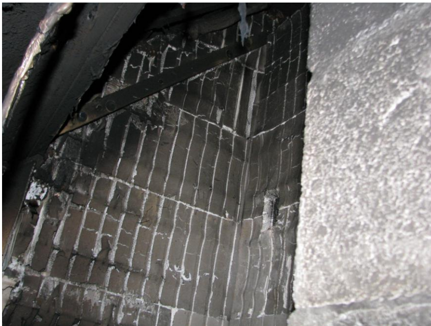
Bild 2 Mit Flammen und Wärme beaufschlagte Polystyrol-Schalelemente.
