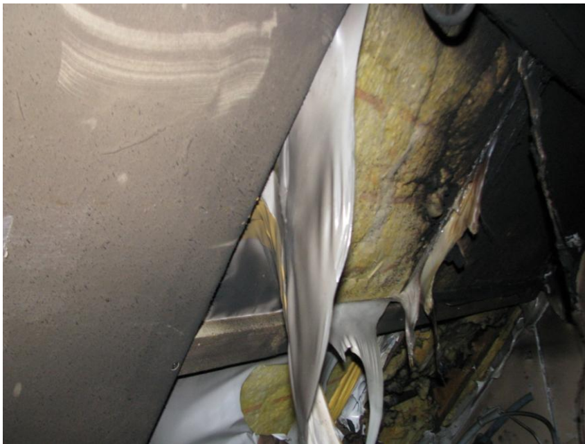
Bild Vom Brand geschädigte Dachschräge im Heizungsraum des Dachgeschosses. Zu erkennen ist die Rußbildung, 1 sowie das Abtropfen der Dampfbremse durch die erhöhte Wärmeeinwirkung während des Brandgeschehens.
