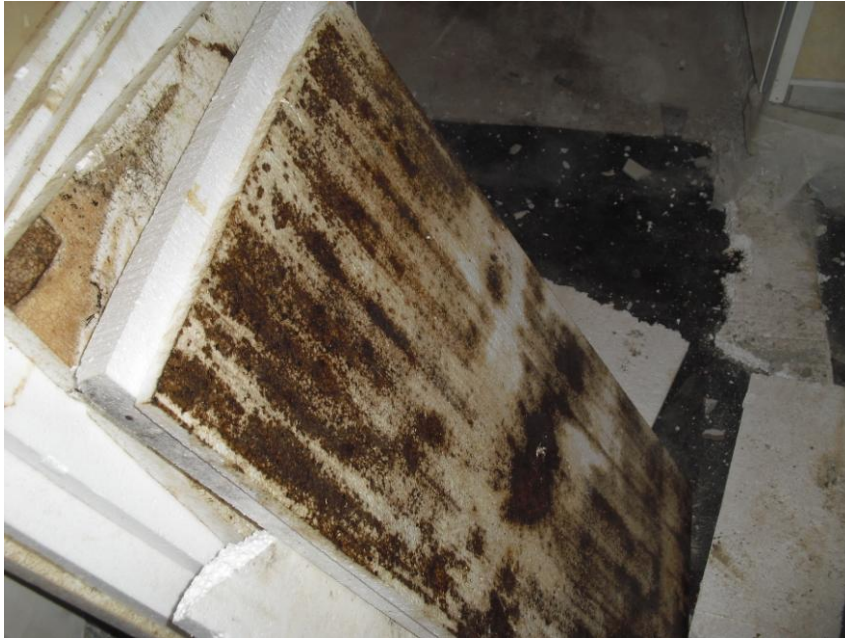
Bild 14 Schimmelpilzbefall auf der Polystyrolplatte.
