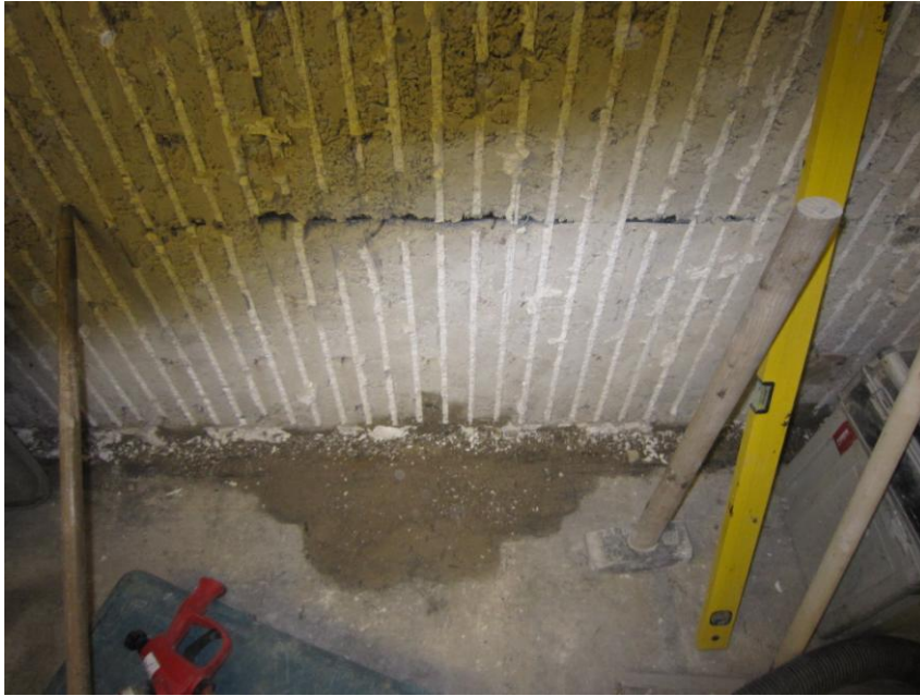
Bild 8 Auch im Wandsohlenbereich mussten Undichtigkeiten festgestellt werden.
