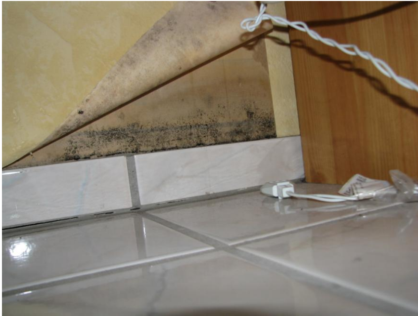
Bild 3 Schimmelpilzrasen unter der Vinyltapete im Untergeschoss – wobei auf der Tapete keine Schäden festgestellt werden konnten.
