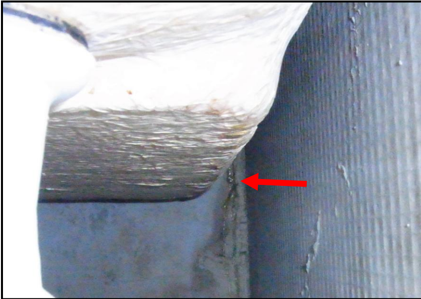
Bild 4 Sichtbares Rinnsal an der Trennwand zur Waschküche unterhalb der Duschtasse bei einer Duschsimulation.
